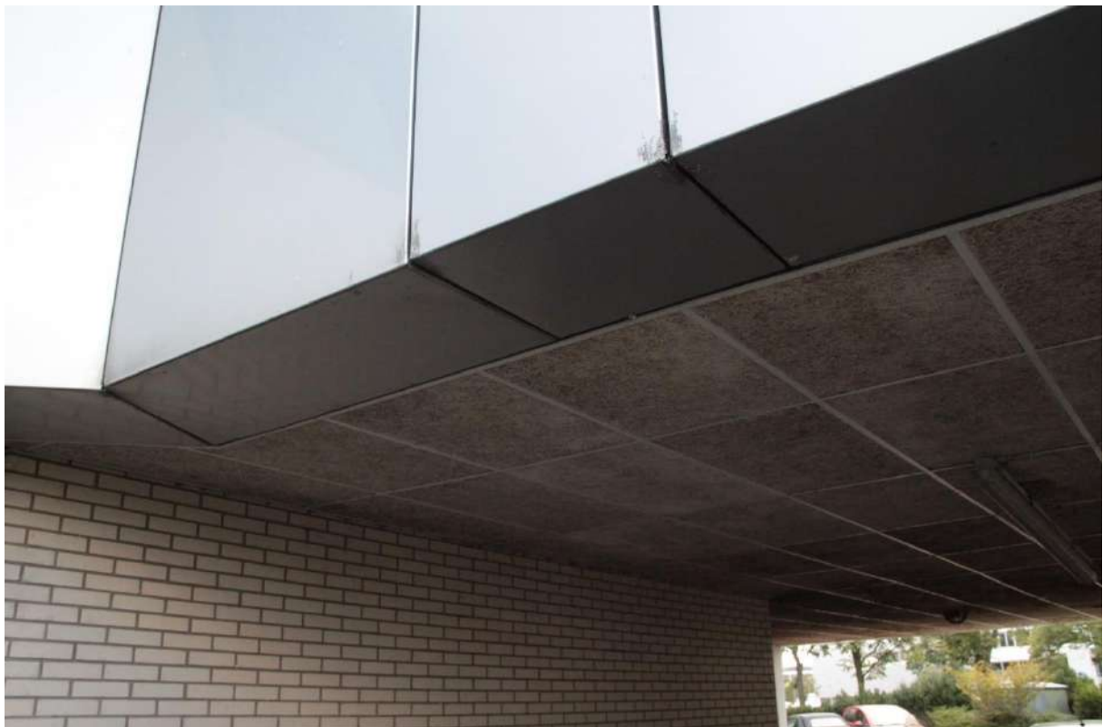
Figuur 10: Tussen de metalen panelen bevinden zich weliswaar kieren, maar deze zijn ontoegankelijk voor vleermuizen.
