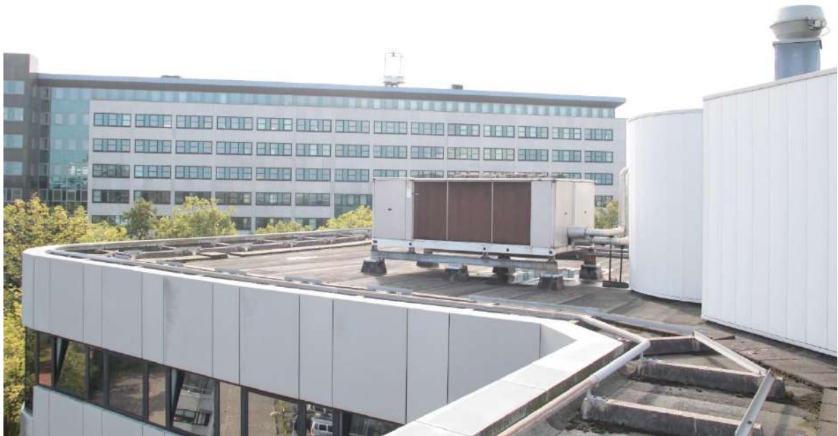
Figuur 8: Op het dak bevinden zich geen openingen, kieren of nissen welke toegankelijk zijn voor vleermuizen of vogels.
