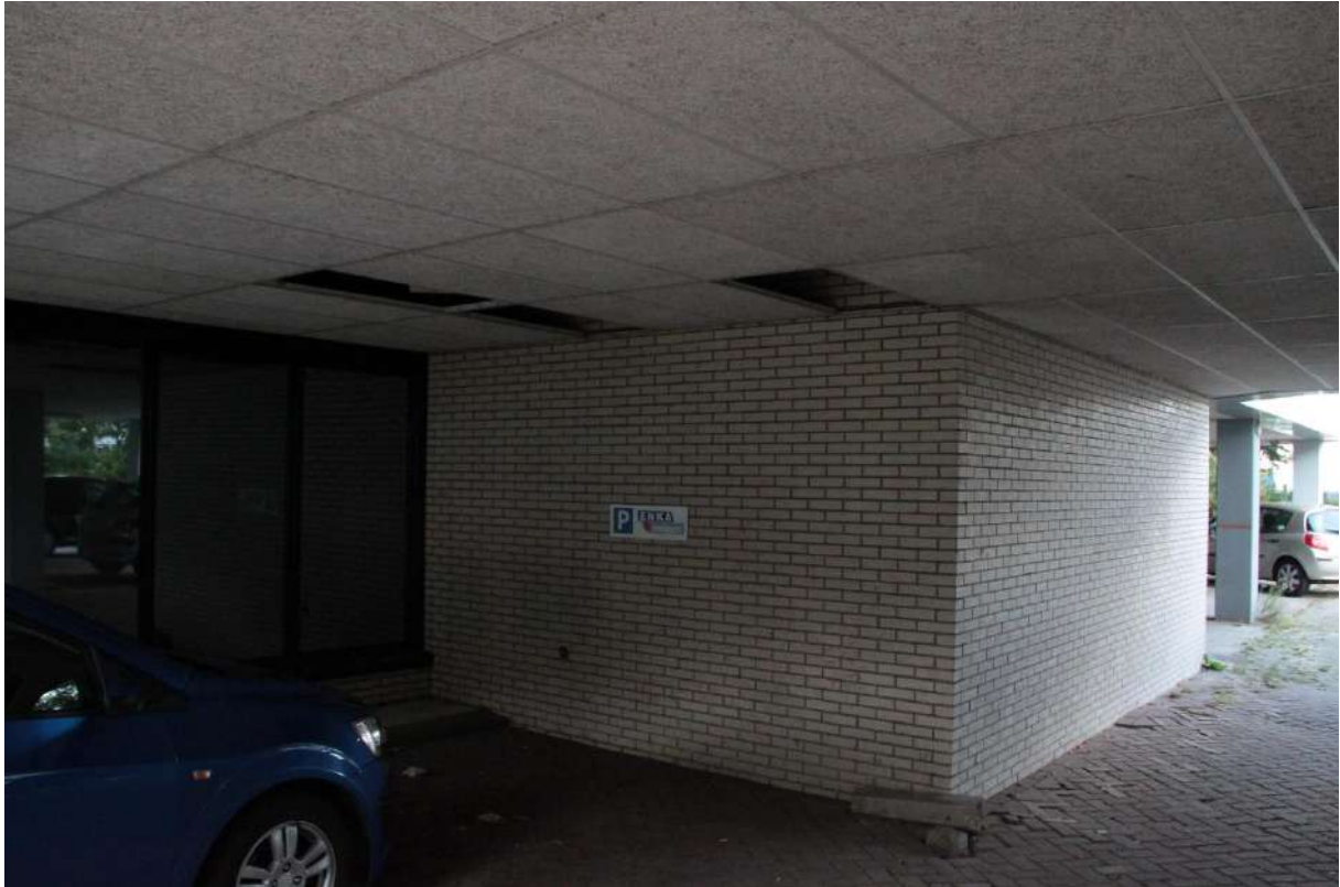
Figuur 12: Enkele plafondplaten ontbreken. Erboven bevindt zich een kleine ruimte met daarboven isolatiemateriaal.
