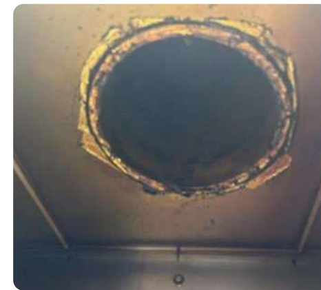
Verhoogd brandrisico door onvoldoende onderhoud van rookkanalen.
