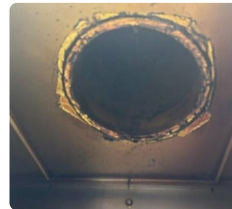
Verhoogd brandrisico door onvoldoende onderhoud van rookkanalen.
