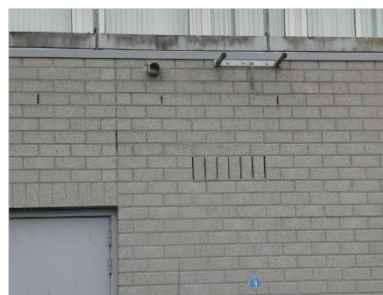
Figuur 4.6 Ventilatievoegen bij bebouwing 3.
