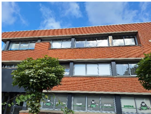
E. Pand 4: Limpergstraat 4. Open stootvoegen aanwezig in voorgevel en bijgebouw.
