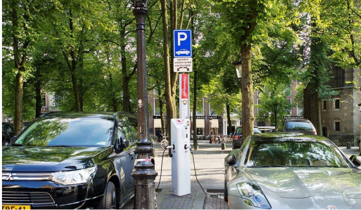
Figuur 18: Publieke laadpaal met netaansluiting in Utrecht
