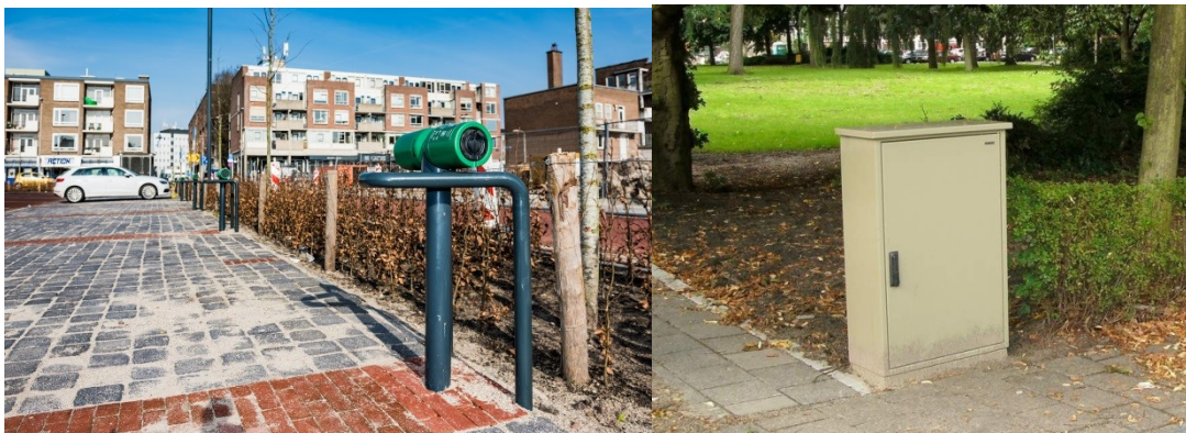
Figuur 19: laadplein en systeemkast
