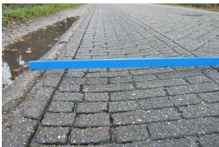
Figuur 5 Schadebeeld ernstige spoorvorming op elementenverharding
