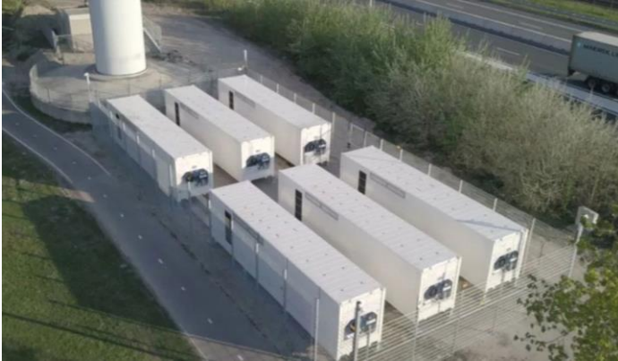
Afbeelding IV.3 Greenchoice Wind batterij Hartelkanaal (haven van Rotterdam) - 10 MWh
