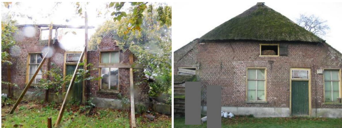
Figuur 5 - Links de huidige situatie van de achtergevel; het gedeelte boven de deur is ongestort; de gevel is gestut. Rechts de situatie in 2008.
