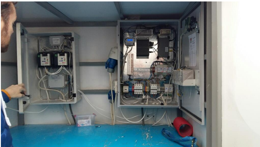
Binnenkant technische ruimte
