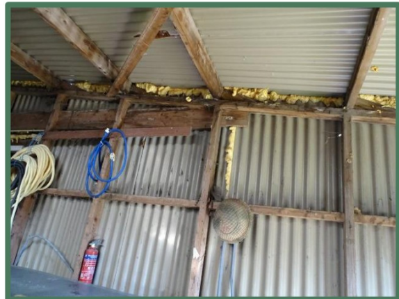
Oud bouwschuim in kieren tussen de golfplaten
