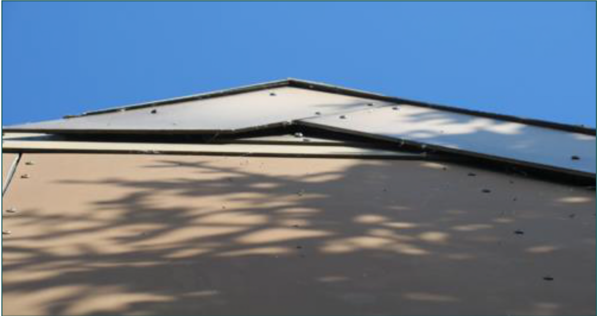
Figuur 3.1 De kunststof platen afwerking op de woning sluit goed aan op de muren en is een te gladde ondergrond voor vleermuizen om de bebouwing te betreden.
