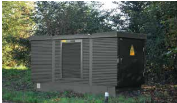
referentie trafo in donkere kleurstelling
