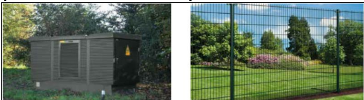
figuur 11. Referentie trafo en staafmathekwerk in donkere kleurstelling
