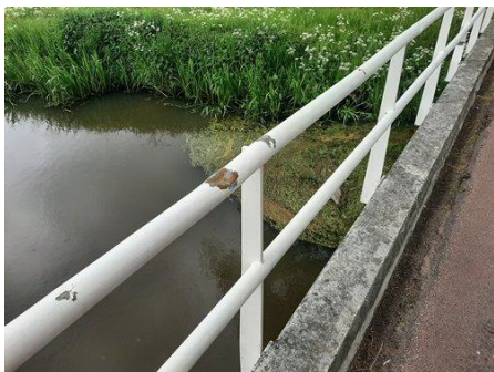
Plaatselijk voorkomende roest
