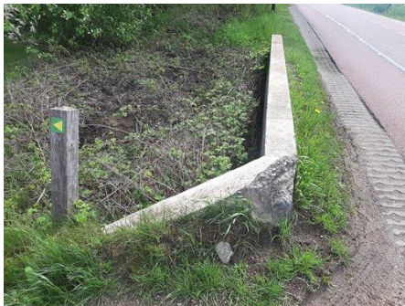
Betonschade aan de bovenkant
