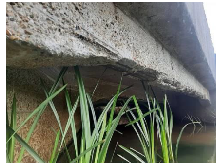
Betonschade aan de hoofd draagconstructie
