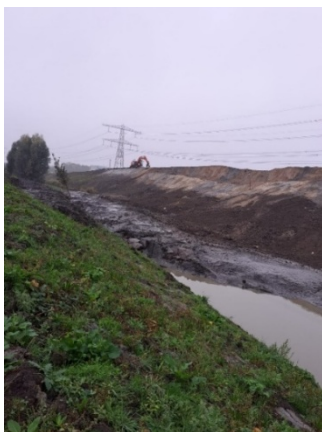
Figuur 2: Opbarsting bodem N211
