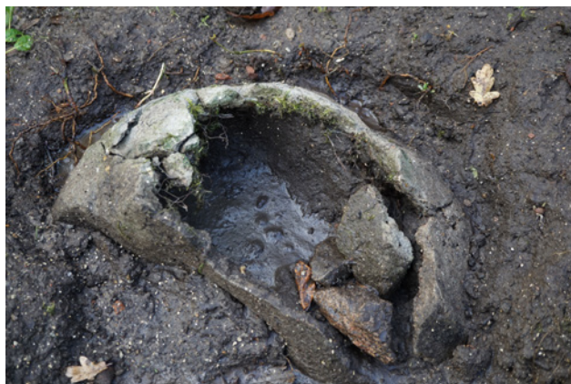
ZICHT OP ÉÉN VAN DE BESCHADIGDE ROTSBLOKKEN RONDOM DE BRUG.
