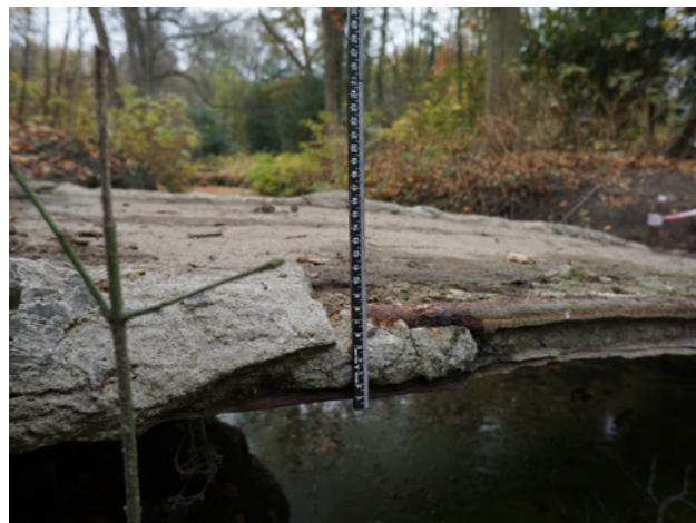
DE ZIJKANTEN VAN DE BRUG ZIJN BESCHADIGD, WAARDOR DE IJZEREN CONSTRUCTIE BLOOTLIGT.
