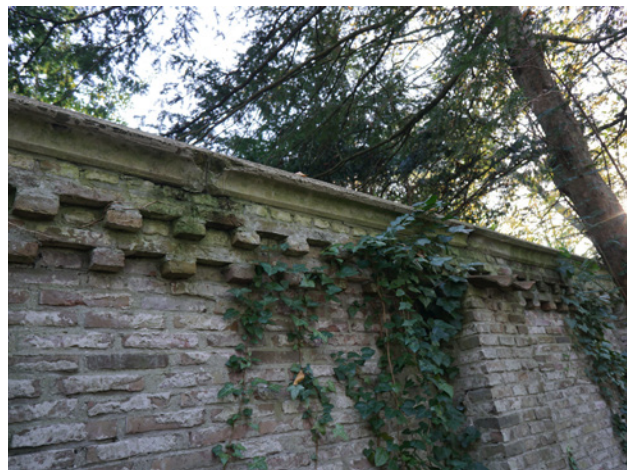
DETAIL VAN DE BOVENZIJD VAN DE TUINMUUR. DE SCHOKBETONNEN AFDEKKERS ZIJN OP MEERDERE PLEKKEN AANGETAST.
