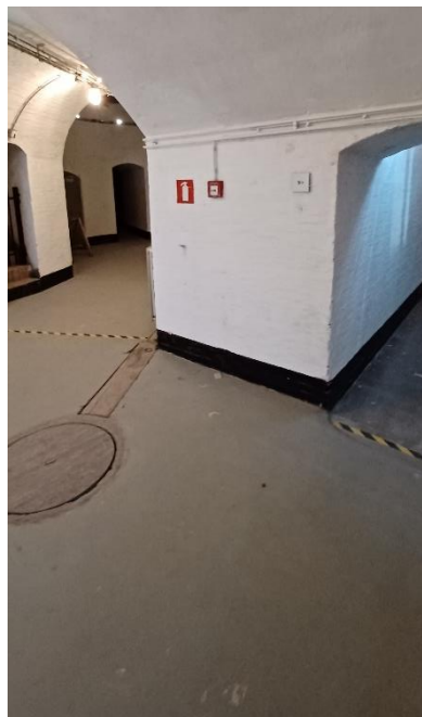
Geen brandblusser aanwezig ondanks aanduiding
