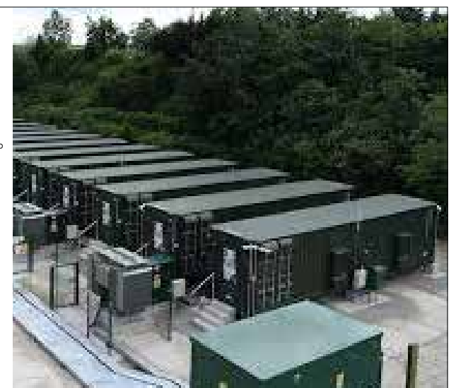
afb. 40: opstelling batterijen (www)
