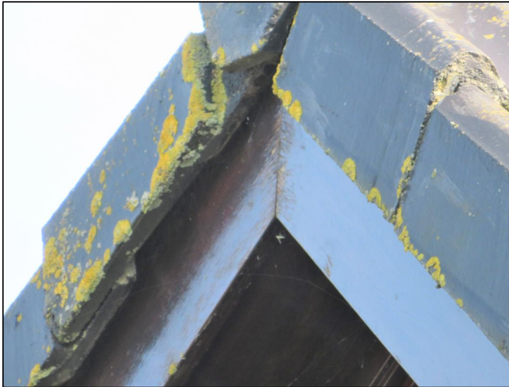
Figuur 4 De kantpannen van de dakkapel bieden voldoende ruimte voor kleine vleermuissoorten.
