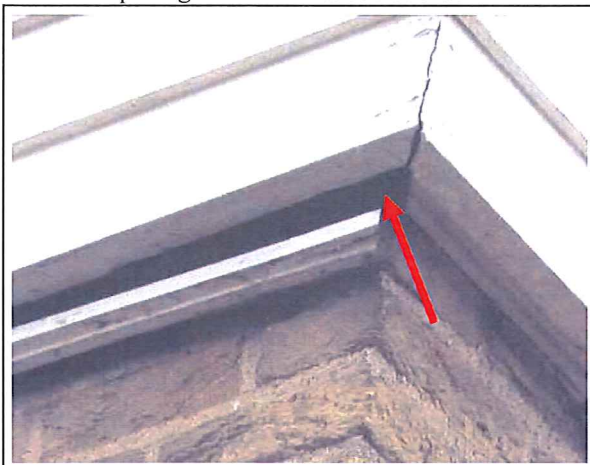
Foto 15: opening door losse lat boeiboorden
