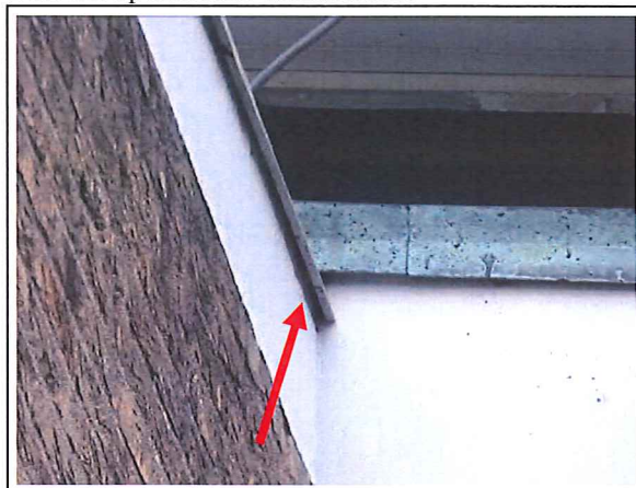
Foto 12: openstaande dakrand kerk
