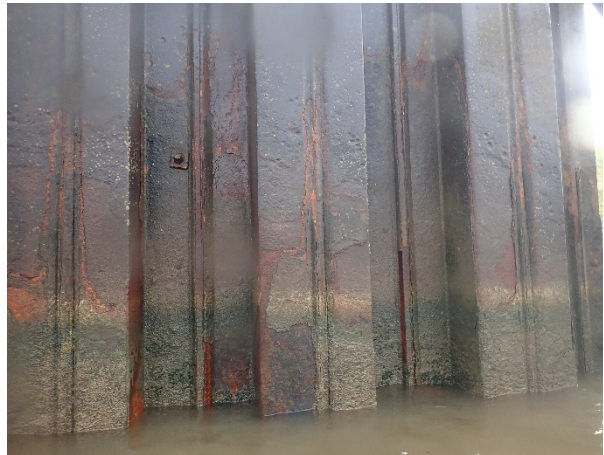
Figuur 6.2: Overzicht corrosie spatzone.
