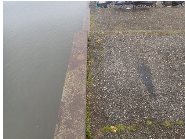
Figuur 6.8: Verzakking asfaltverharding.
