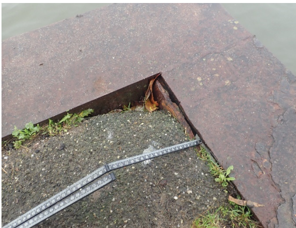
Figuur 6.9: Verzakking asfaltverharding.
