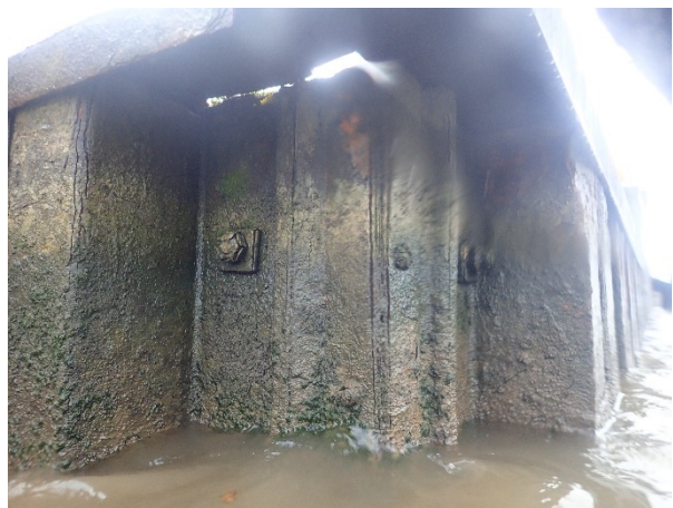
Figuur 6.6: Corrosie klinknagels passtuk.
