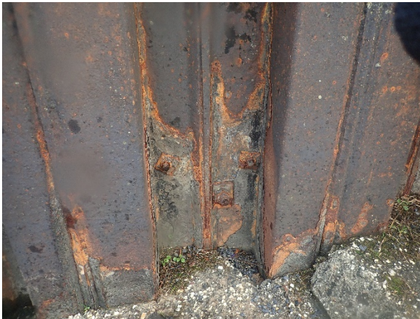
Figuur 6.1: Corrosie boutkoppen.
