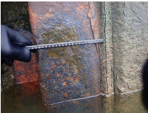
Figuur 6.3: Corrosie spatzone.
