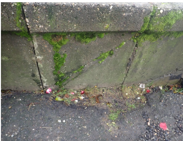
Figuur 6.11: Gescheurde betonelementen.
