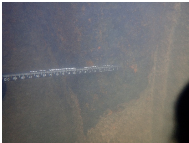
Figuur 6.4: Corrosie permanent onderwaterzone.
