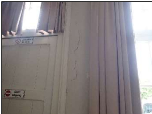
Binnenwanden zaal, scheurvorming
