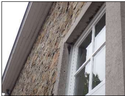
Scheefstand blauwsteen omlijsting t.p.v. westgevel
