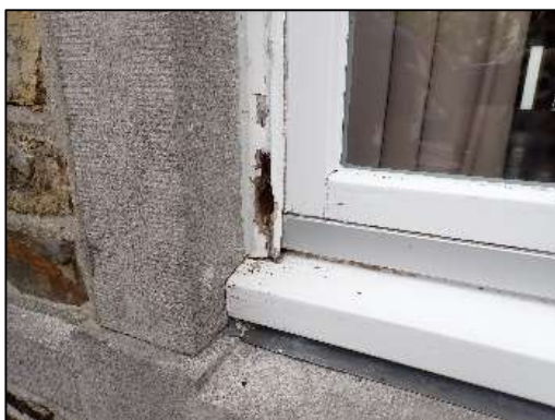
Houtrot t.p.v. westgevel
