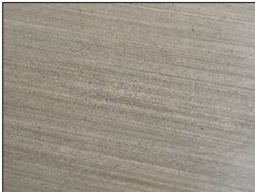
Slijtagesporen linoleum vloer zaal
