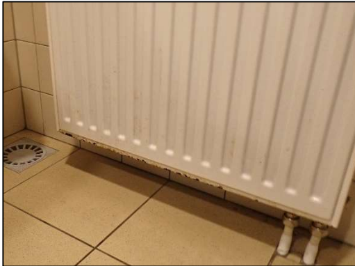
Corrosie radiator sanitaire ruimte
