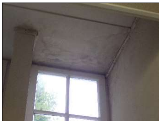
Plafondafwerking garderobe (vochtsporen)
