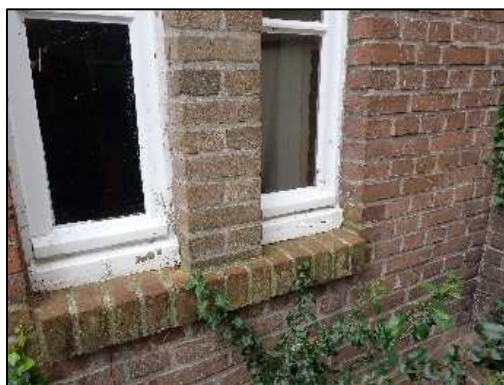
Noordgevel, afbladderend schilderwerk
