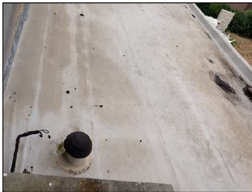
Vervuilde PVC dakafwerking
