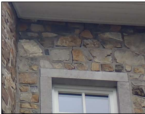
Scheurvorming t.p.v. zuidgevel
