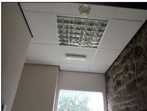
Armatuur met TL verlichting
