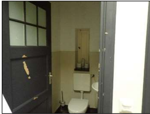
Beschadigingen schilderwerk op kozijn en deur
