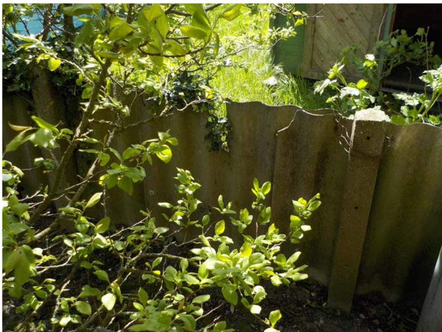
Foto 4. Scheidingsplaat van asbestverdacht materiaal.
