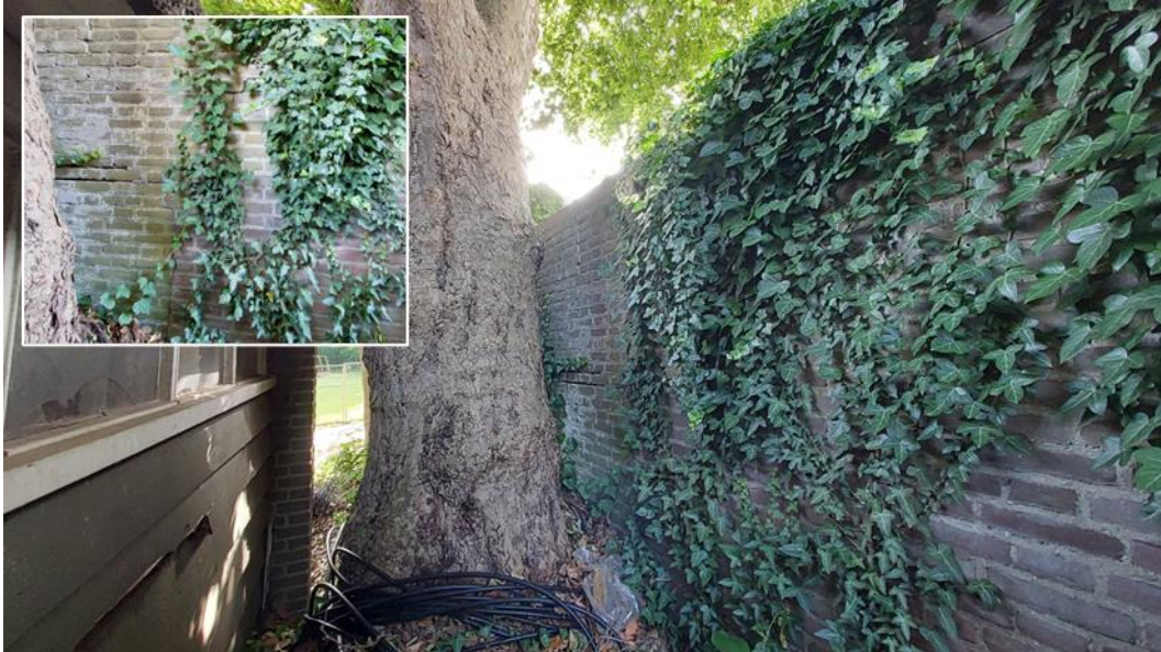
Foto 5. Boom 4 groeit met haar stamvoet en wortels tegen de scheidingsmuur. Inzet; ter hoogte van de boom zijn scheuren zichtbaar
