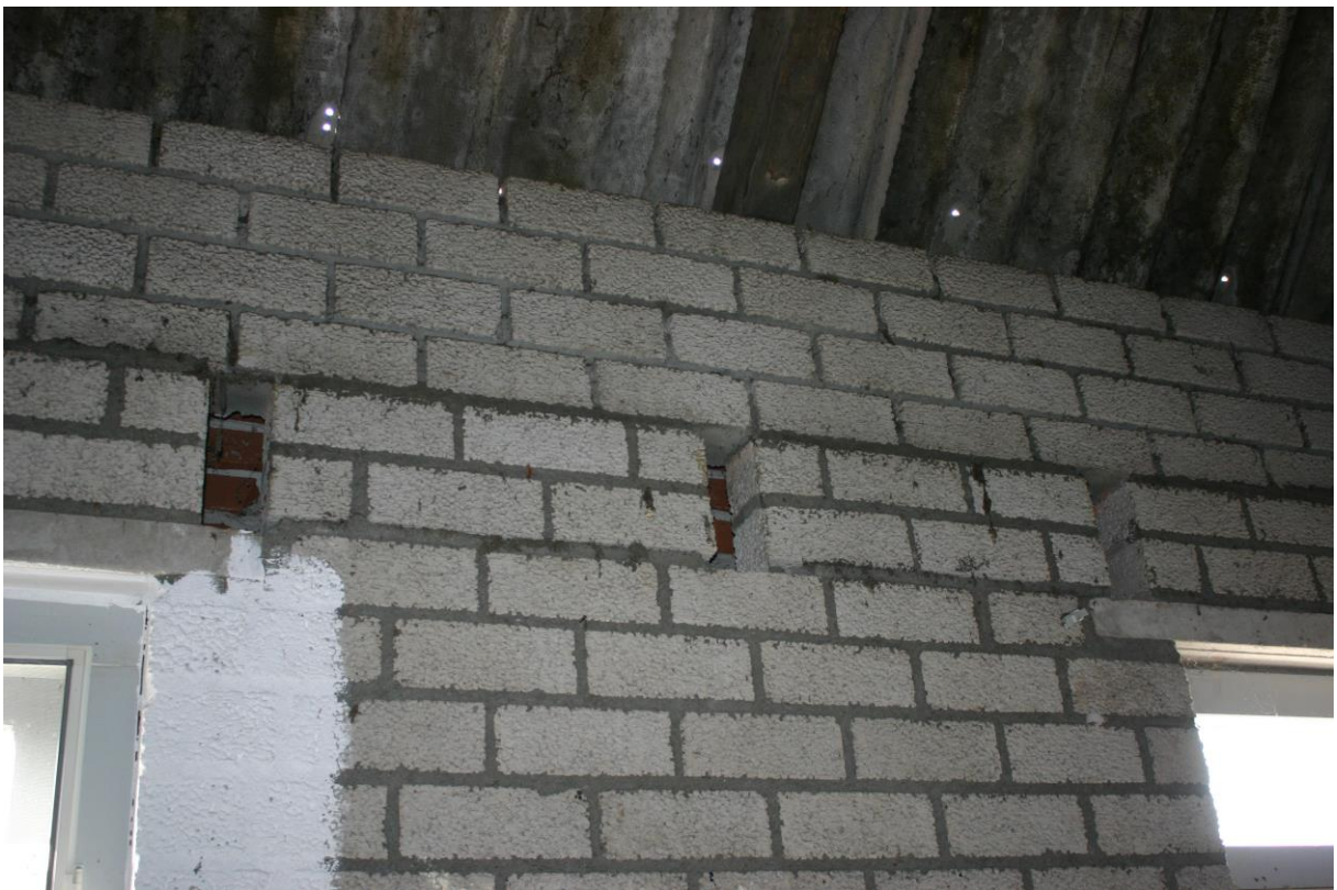
Figuur 4.2.4. Gaten in de binnengevel van de schuur.
