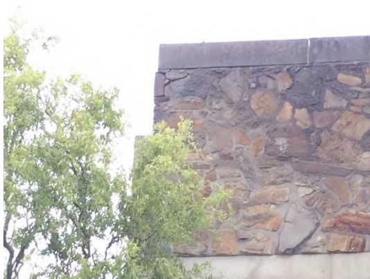
Figuur 7: Schade aan metselwerk en de betonnen
