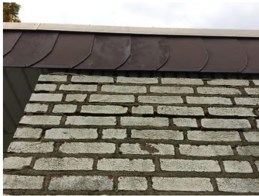
Figuur 10: Kierende boeiboorden bij de aangelegen woningen.
