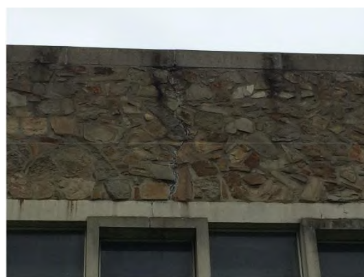
Figuur 8: scheurvorming in de buitenmuur
