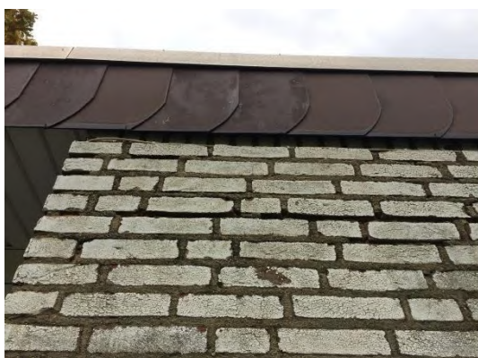
Figuur 11: Kierende boeiboorden bij de aangelegen woningen.
