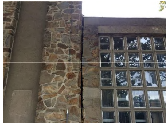
Figuur 9: Open dilatatievoeg tussen kerkgebouw en klokkentoren.
