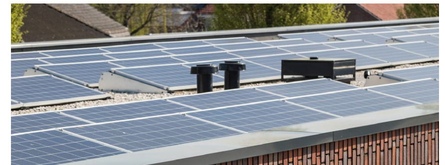
Figuur 63: Installaties zoals zonnepanelen op een kwalitatieve wijze als ingepast in de architectuur
