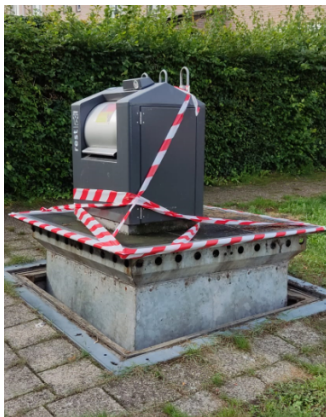
De veiligheidsvloer en de kabel van de Container is kapot, waardoor de container niet meer in de grond kan. Deze steekt nu uit
