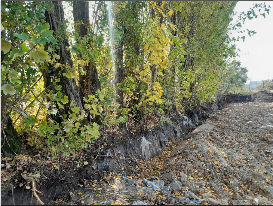
Afbeelding 4 : Detailopname verwijderde beton
