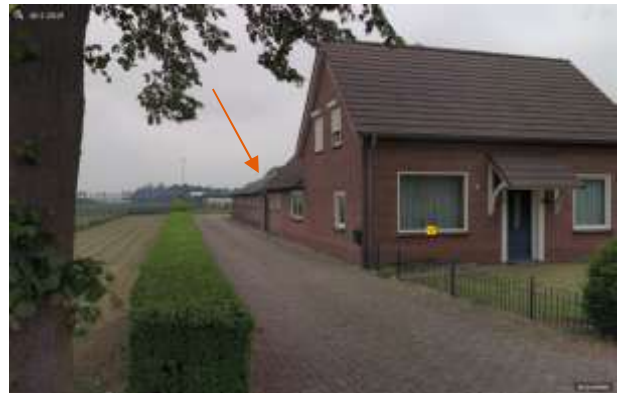
Foto 7: schuur met asbestverdacht dak op perceel van Burgt 17
