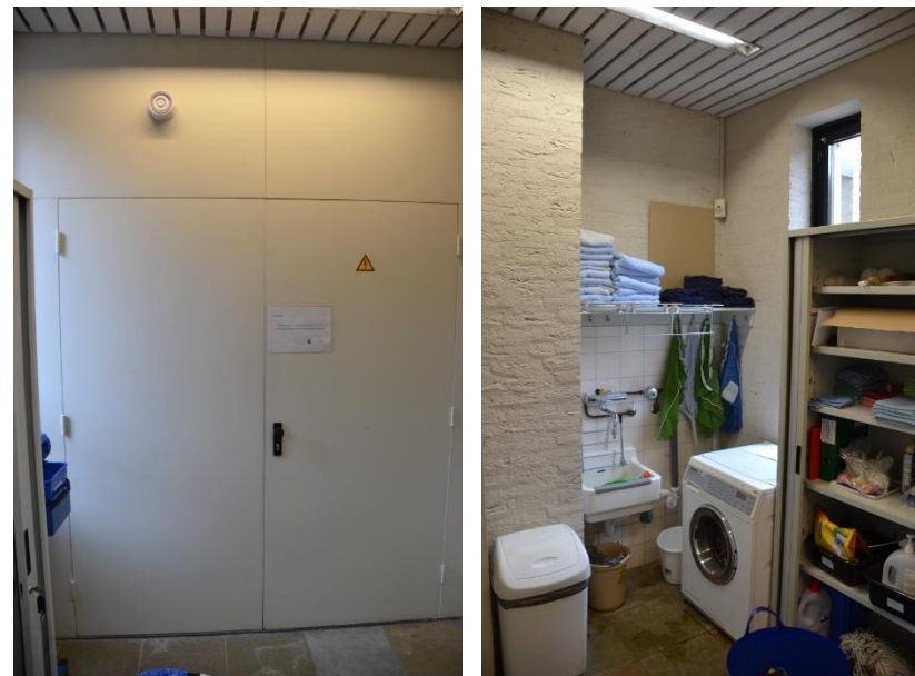
Links: grote meterkast in ruimte 0.43. Rechts: ruimte 0.43 vanaf de meterkast gezien.
