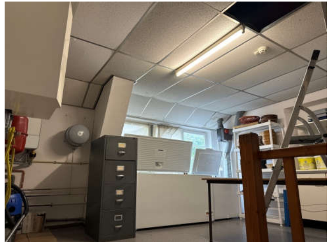
cv-ruimte achter ingang zalen
