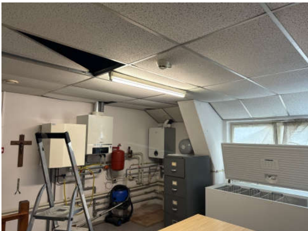
cv-ruimte achter ingang zalen
