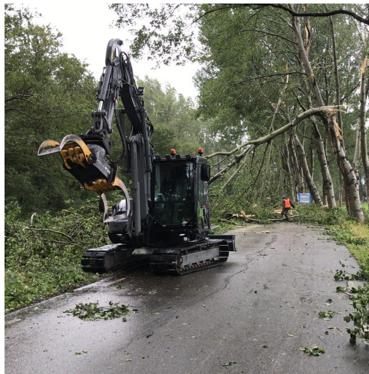
Afbeelding: herstelwerkzaamheden na storm Poly
