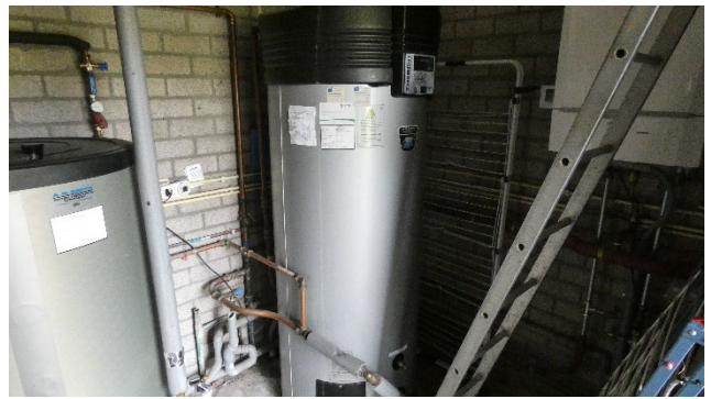
Foto 10: Techn. Ruimte met CV en boilers
