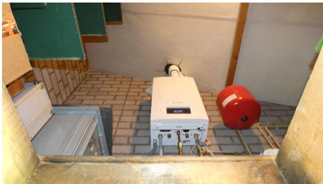
Foto 25: bergzolder met opstelling CV (ca 2024/2025?)
