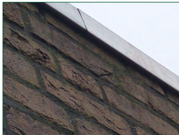
foto 4: Wijkende daklijst bij schoolgebouw
