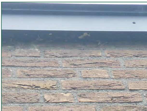
foto 10: Wijkende dakrand van het kinderdagverblijf, waarbij te zien is dat deze gedicht is met hout.
