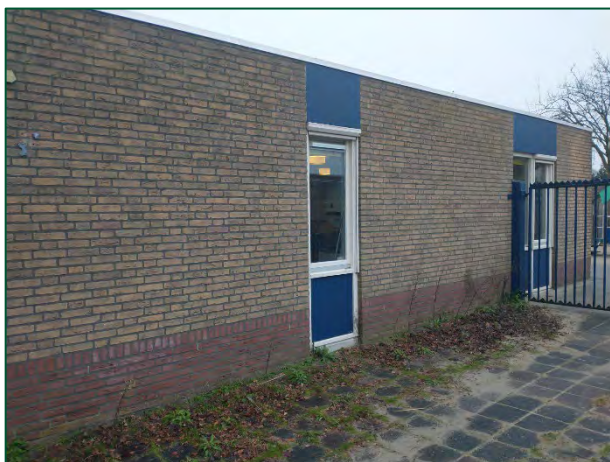
foto 11: gevel van het kinderdagverblijf waarop te zien is dat er geen stootvoegen aanwezig zijn
