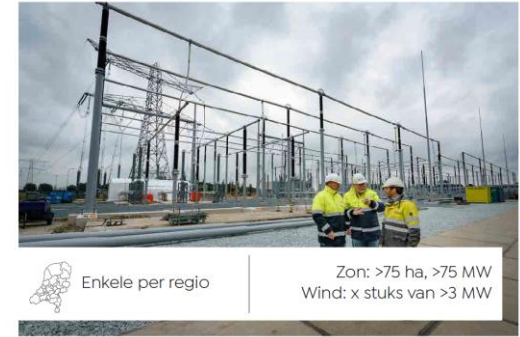
HS-TS station (van 110-150 naar 25-66 kV)
