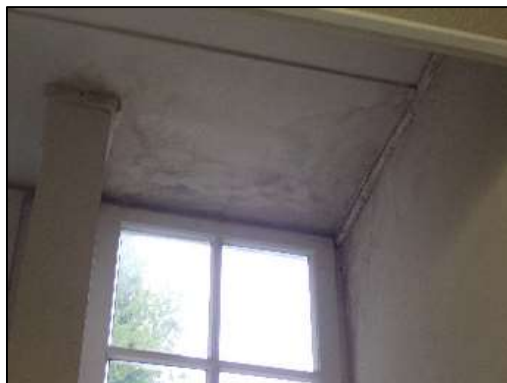
Plafondafwerking garderobe (vochtsporen)
