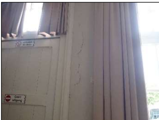
Binnenwanden zaal, scheurvorming
