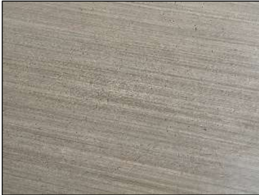
Slijtagesporen linoleum vloer zaal
