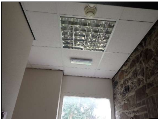
Armatuur met TL verlichting
