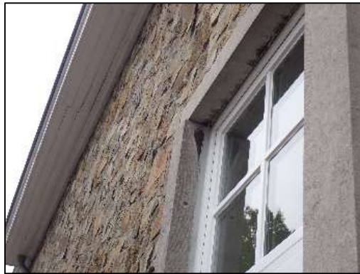
Scheefstand blauwsteen omlijsting t.p.v. westgevel
