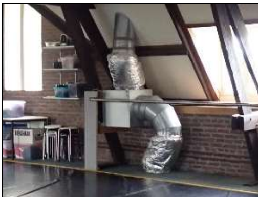
Verouderde ventilatiebox zaal
