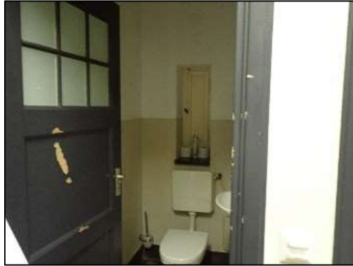
Beschadigingen schilderwerk op kozijn en deur
