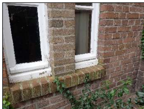
Noordgevel, afbladderend schilderwerk
