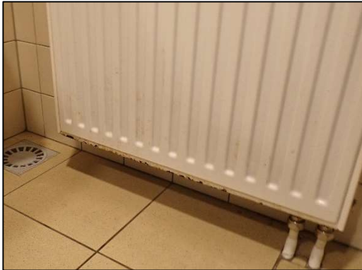
Corrosie radiator sanitaire ruimte
