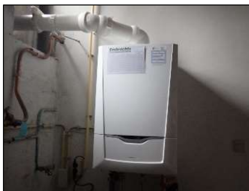
Nieuwe cv-ketel uitbreiding
