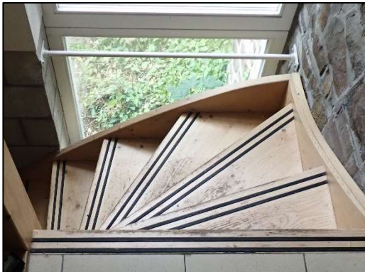
Slijtagesporen lakwerk houten trap
