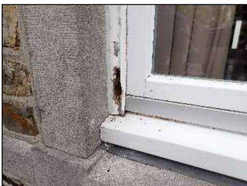
Houtrot t.p.v. westgevel
