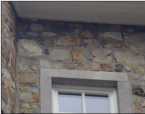
Scheurvorming t.p.v. zuidgevel
