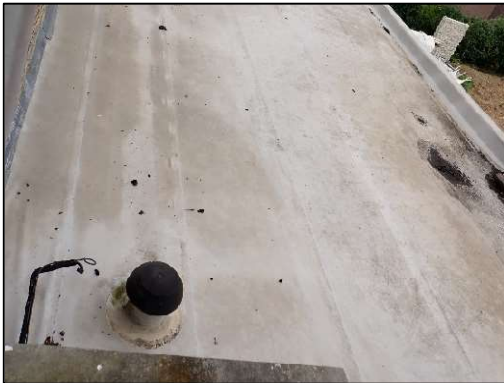
Vervuilde PVC dakafwerking
