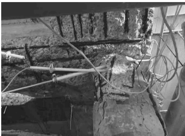
Figuur 4.1: Constatering betonrot tijdens inspectie
