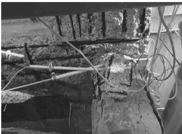
Figuur 4.1: Constatering betonrot tijdens inspectie
