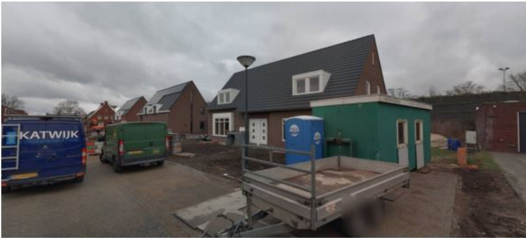
Foto 1 / 9 maart 2021 van de in aanbouw zijnde woningen aan de Gulden. De gronden zijn in 2019 geleverd. Gefotografeerd vanaf Gulden in westelijke richting.
