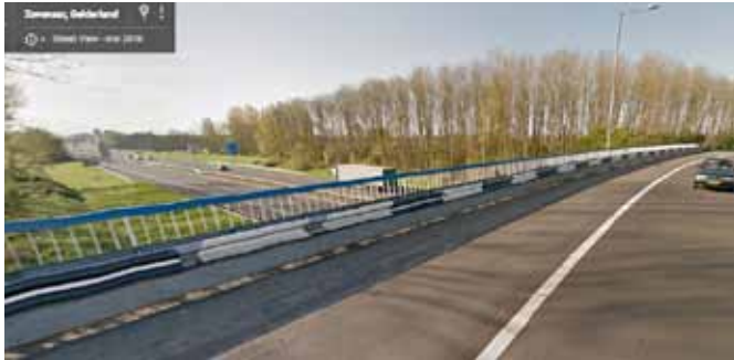
Viaduct in verbindingsweg A18 (knooppunt Oud-Dijk) -> aanpassen kleur leuning
