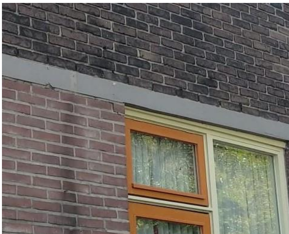
Scheuren aan de buitenkant boven
