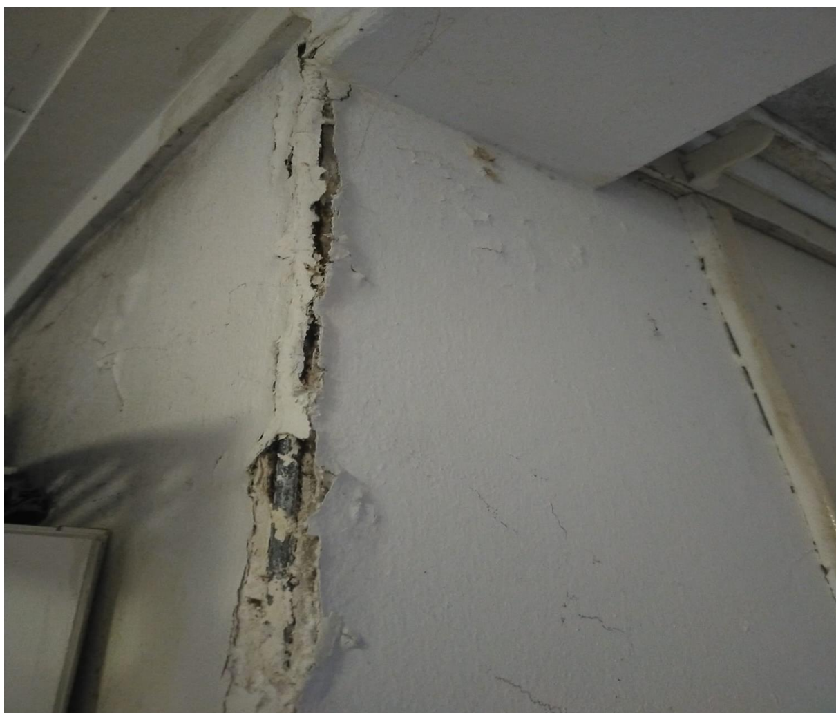
Vochtprobleem door achterstallig onderhoud, lekkage dak in de keuken.
