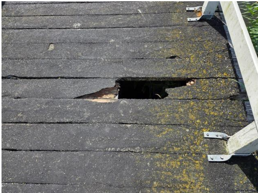
Gat in brugdek Galggouw waar een paard doorheen zakte.
