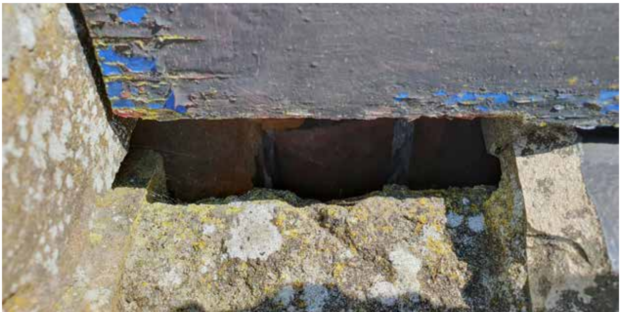
Figuur 13. Openliggende spouwmuur onder een raamkozijn aan de westzijde (invliegopening vleermuizen).
