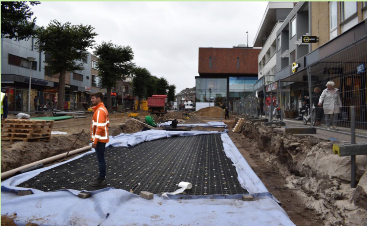
Afbeelding 7: Berging en infiltratie van hemelwater op de Markt in Uden
