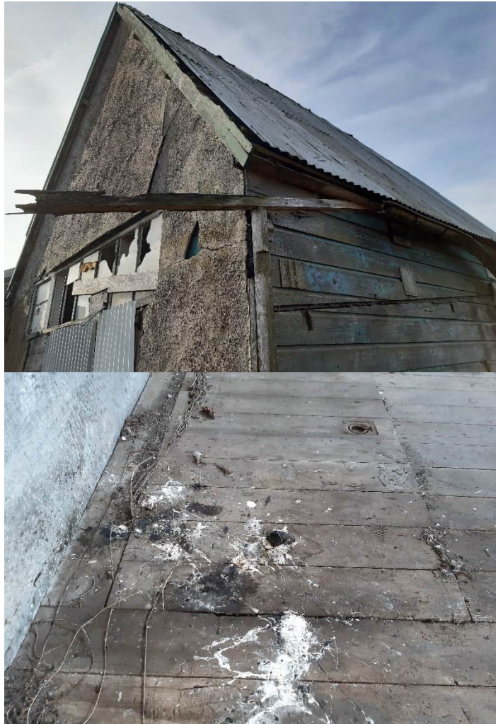
Figuur 6. Vervallen schuur binnen het projectgebied west vormt een rustplaats van kerkuil. Uitwerpselen en braakballen aanwezig. Aanwezigheid van een nestplaats is niet uitgesloten.
