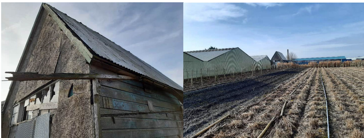
Figuur 20. Foto-impressie projectgebied. Foto links: Vervallen schuur waar een rustplaats van kerkuil is vastgesteld. Foto rechts: Kwekerij met vervallen schuur op de achtergrond.
