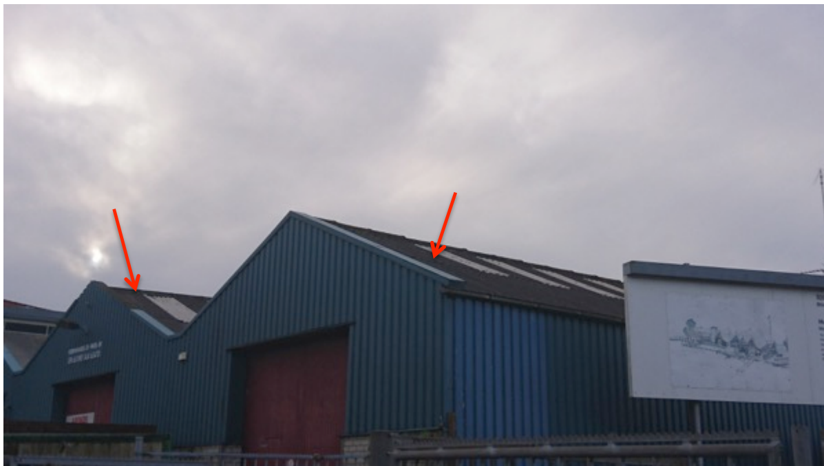
F1: Asbesthoudende golfbeplating (incl. nokvorsten) op het dak van loods II en loods III
