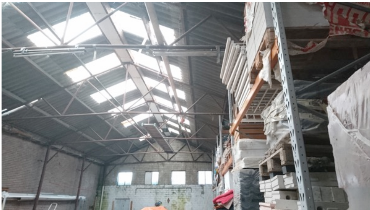
F2: Asbesthoudende golfbeplating (incl. nokvorsten) op het dak van loods II en loods III
