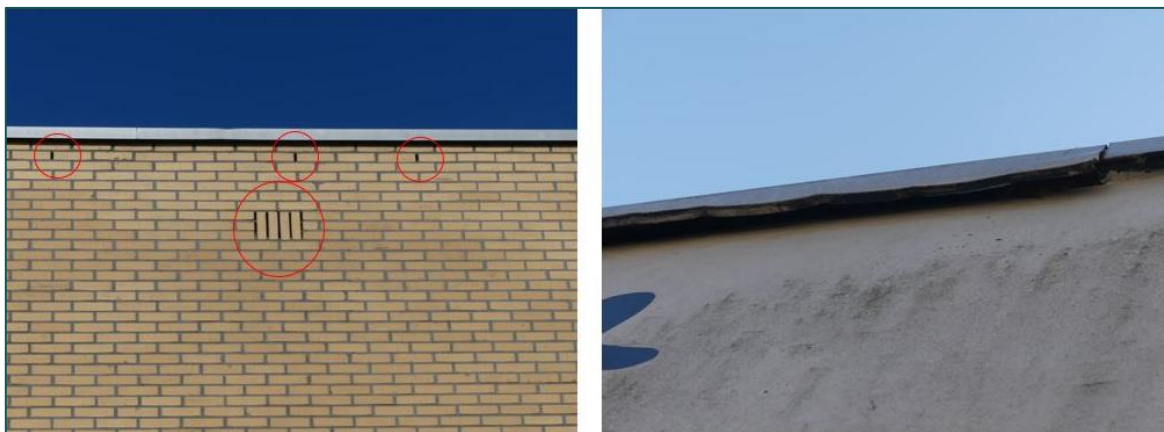
Figuur 3.1 Openingen waardoor vleermuizen in de spouw kunnen komen. Links open stootvoegen en ventilatieschachten en rechts ruimte tussen de muur en de daklijst.
