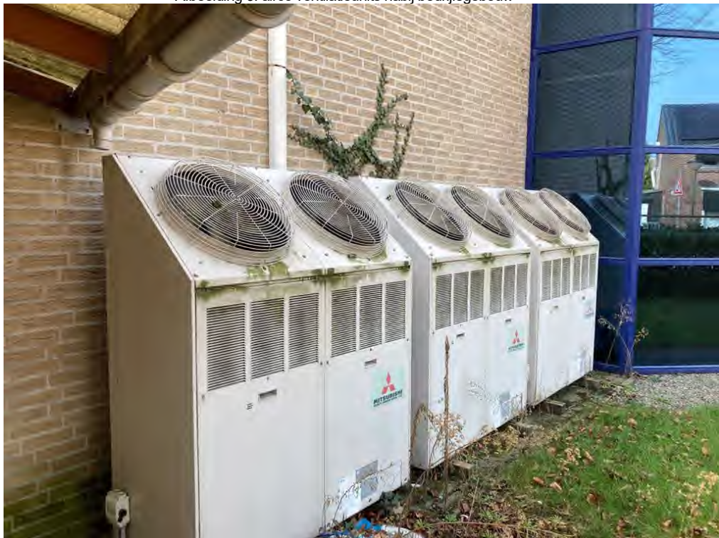
• Afbeelding 9: airco ventilatieunits nabij bedrijfsgebouw
