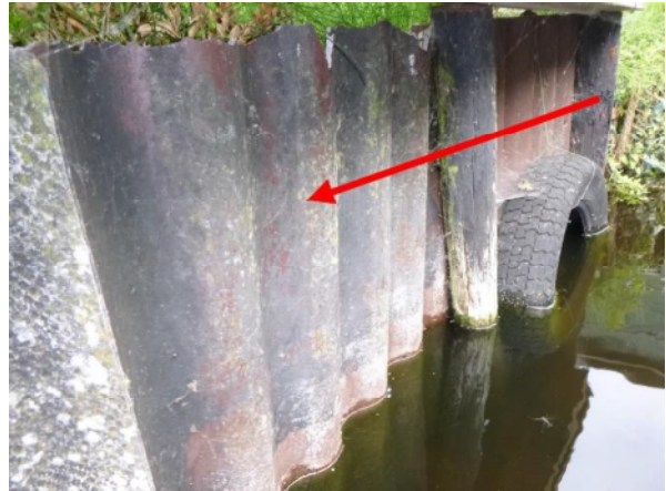
Foto 21 | Foto voor bron Golfplaat
